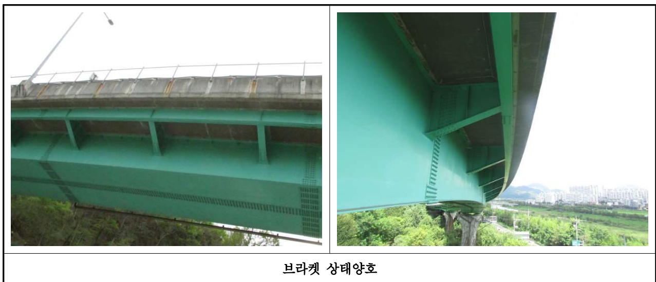
【사진 3.10】 2차부재(브라켓) 손상현황
