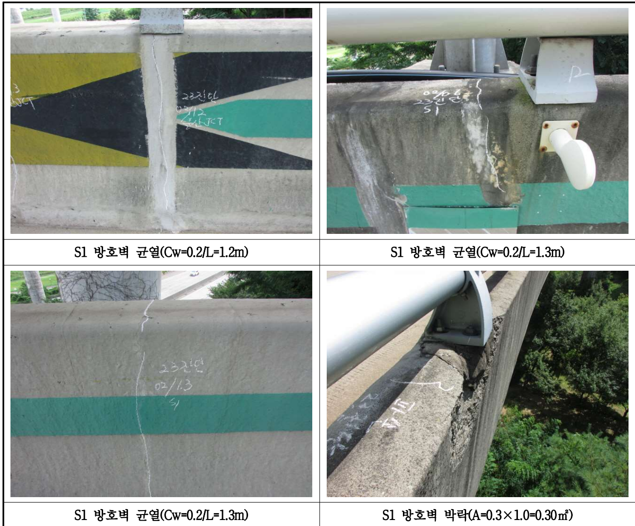
【사진 3.26】 난간 및 연석(방호벽) 손상현황
