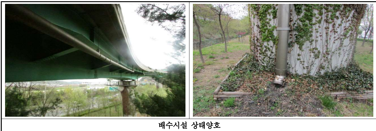
【사진 3.24】 배수시설 손상현황
