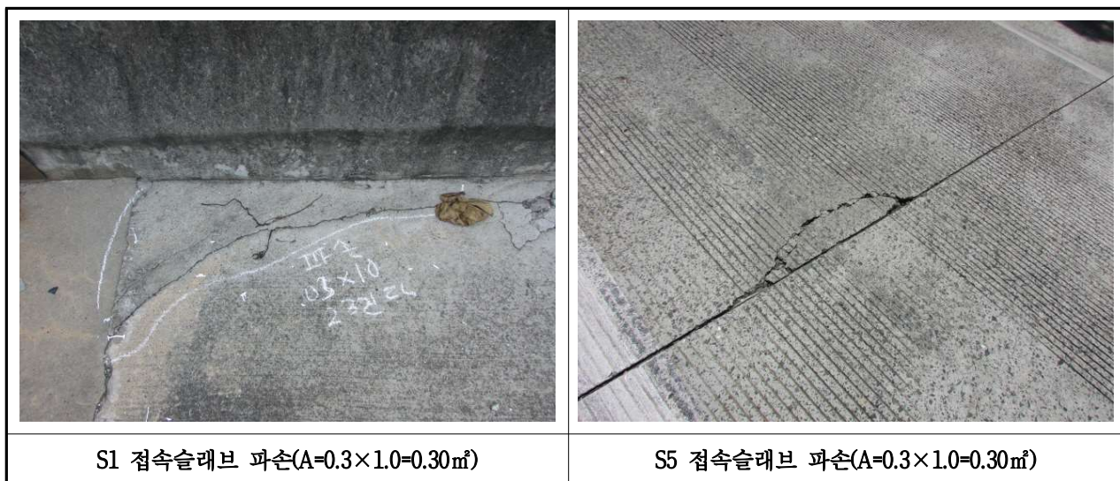
【사진 3.22】 교면포장 손상현황
