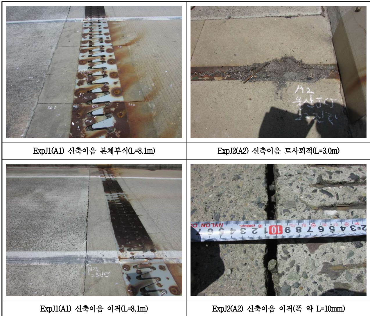
【사진 3.20】 신축이음장치 손상현황
