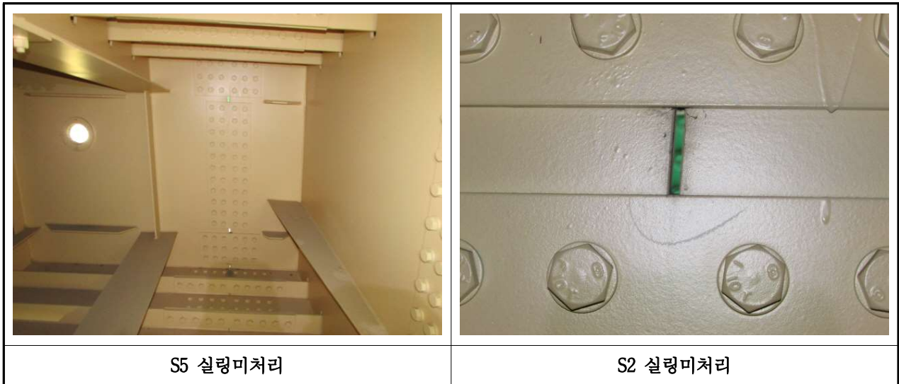
【사진 3.7】 강박스 거더 내부 손상현황
